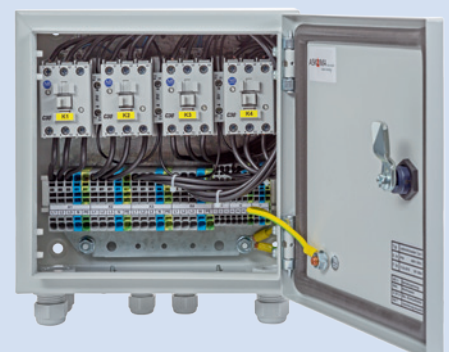
⑧ Schaltbox mit Leistungsschützen
